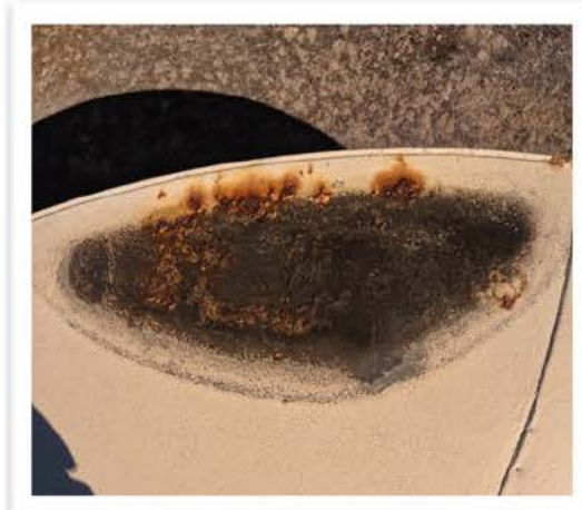
Roof Edge (ponding)
