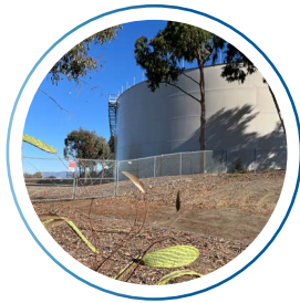
12 Tanques de Acero Cerrados
